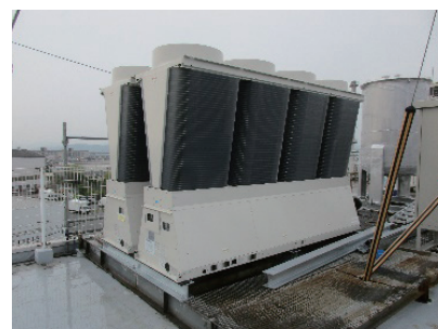
高効率冷凍機 【加古川東工場】
