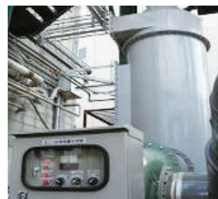
増設脱臭設備【加古川東工場】
