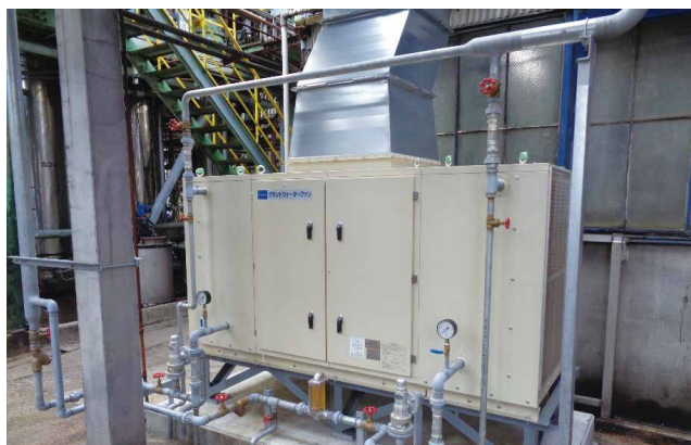
熱交換式涼風給気装置本体
