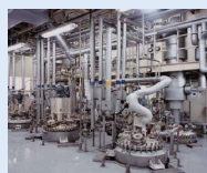
医薬品用リン脂質製造設備
